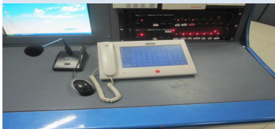
覆盖全院广播呼叫系统
